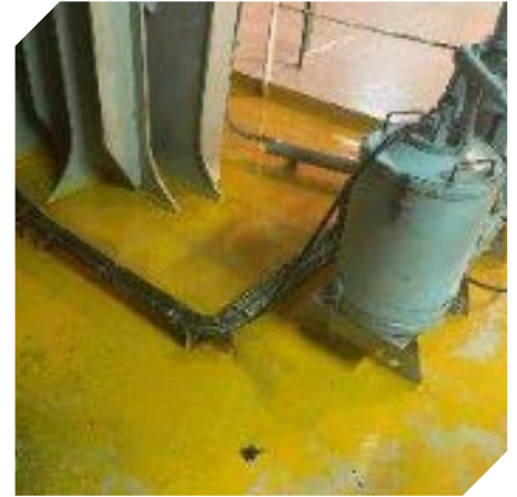
液压油积聚在舵机集油槽中
